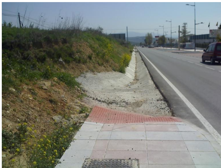
Ilustración 8. Desembocadura del Arroyo Larija a la cuneta de la JA-3305, denominada calle Príncipe Felipe
