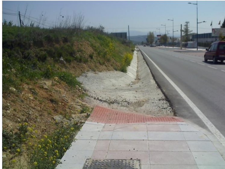
Ilustración 13. Desembocadura del Arroyo Larija a la cuneta de la JA-3305, denominada calle Príncipe Felipe
