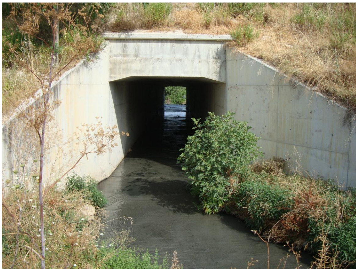
Ilustración 2.- Aspecto actual de la ODT del Arroyo Fuente de la Villa bajo la A-316.
