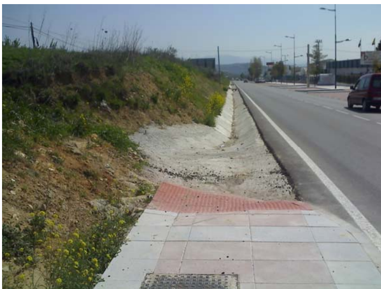
Ilustración 18. Desembocadura del Arroyo Larija a la cuneta de la JA-3305
